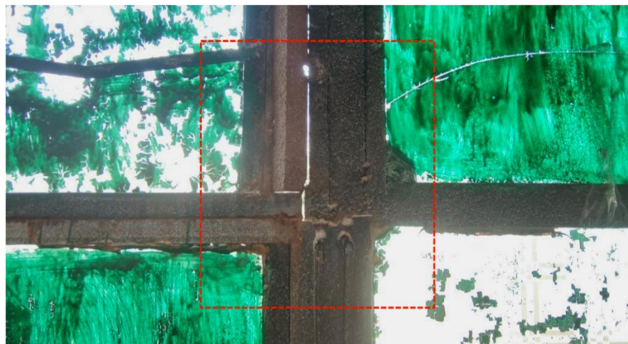
窗户骨架严重锈蚀变形
