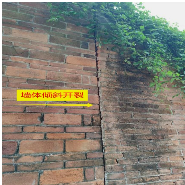
外墙倾斜开裂
