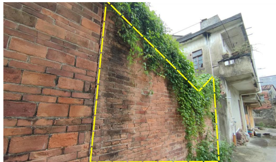
外墙倾斜开裂
