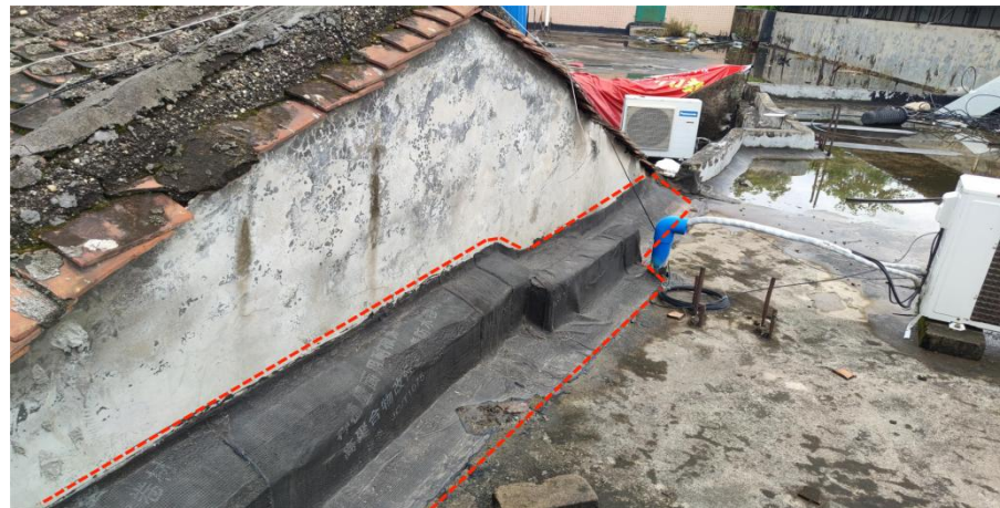
防水卷材脆化开裂
