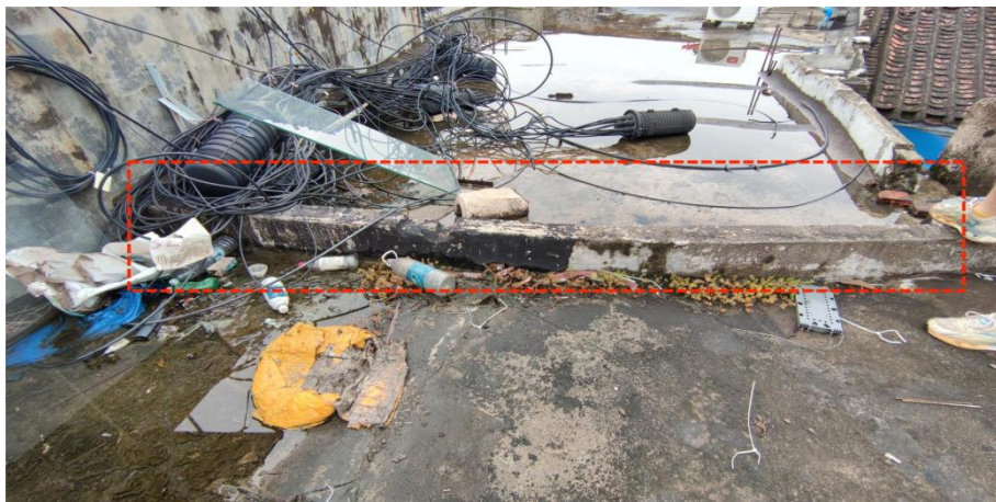
防水涂膜失效渗水
