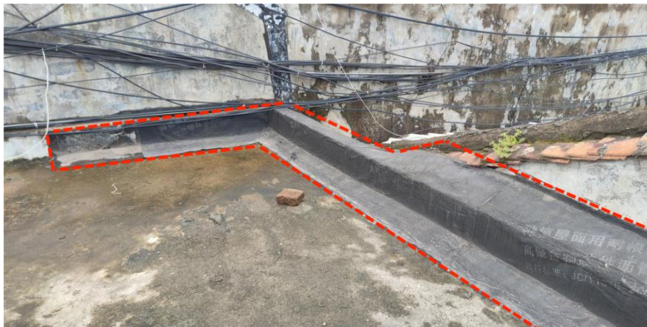
防水卷材脆化开裂
