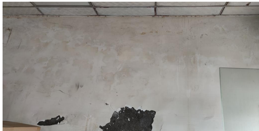
屋面漏水导致墙体发霉
